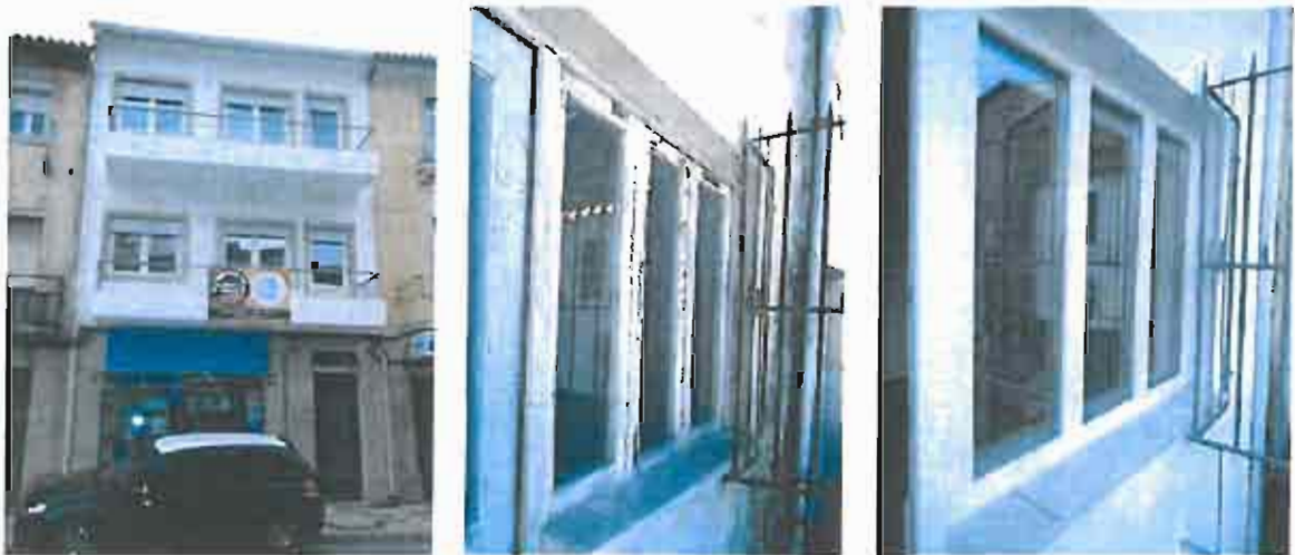
Fotos 61, 62 e 63: Fachada do Imóvel do Largo Major Monteiro Leite 15 depois da reabilitação, pormenor de caixilharia de vidro simples (antes da reabilitação) e substituição por caixilharia de vidro duplo (depois da reabilitação)
