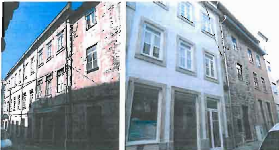
Fotos 53 e 54: Imóvel na Rua do Carmo 15-17, antes e após a intervenção
