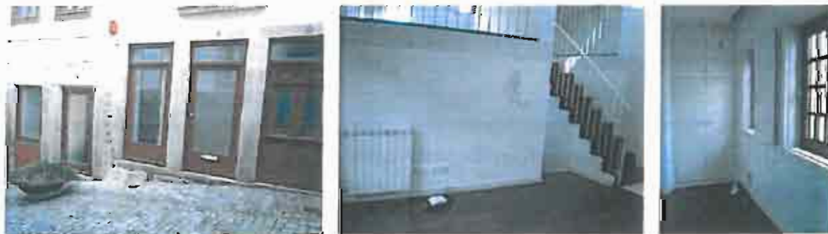
Fotos 67, 68 e 69: Edifício da Calçada da Vigia 7-17
