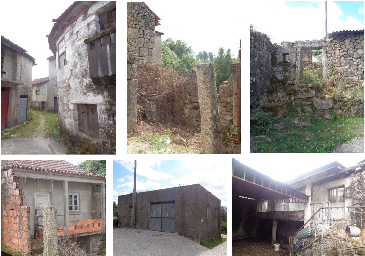
Imagens 22, 23, 24, 25, 26 e 27. Fotografias de construções muito degradadas / em ruínas e com elementos dissonantes.
