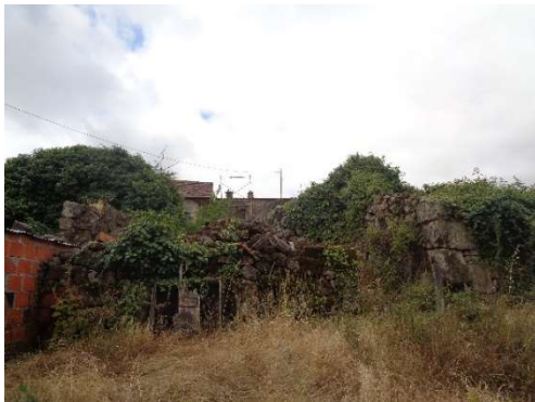
Imagem 31, 32, 33 e 34. Fotografias de construções dissonantes e em estado de degradação / ruínas.
