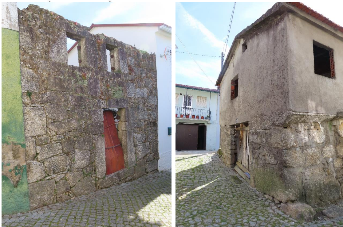
Imagens 10 - 13. Elementos dissonantes, construções degradadas / em ruínas.
