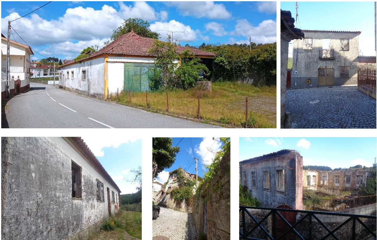
Imagem 23, 24, 25, 26 e 27. Fotografias de construções muito degradadas / em ruínas.
